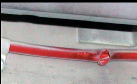
Firetrace tubing “burst”
