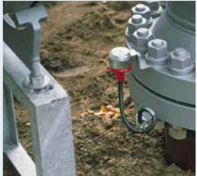
Vía de chispas de separación homologada por ATEX para la compensación de potencial de protección contra el rayo según DIN V VDE V 0185 en ejecución acreditada con conexión flexible de conductores.
